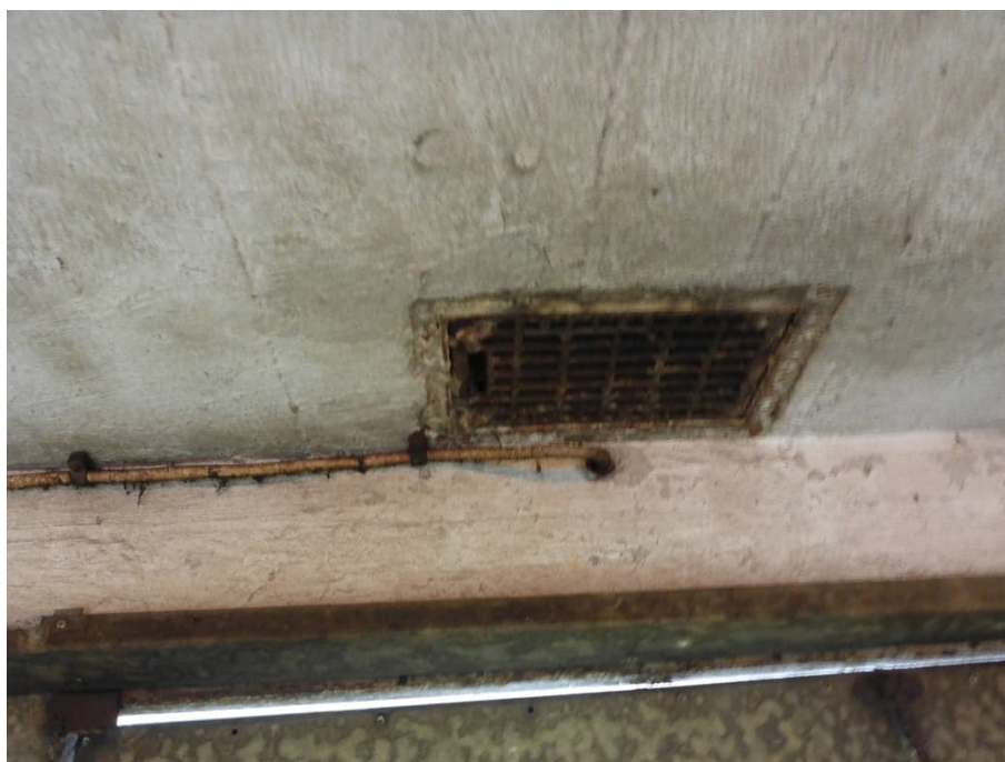
Kuva 20, porrastornin ilmanvaihtoritilä pahoin ruostunut
