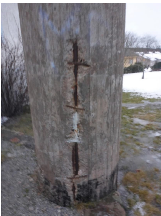
Kuva 2, merkittävin vaurio pilarissa
