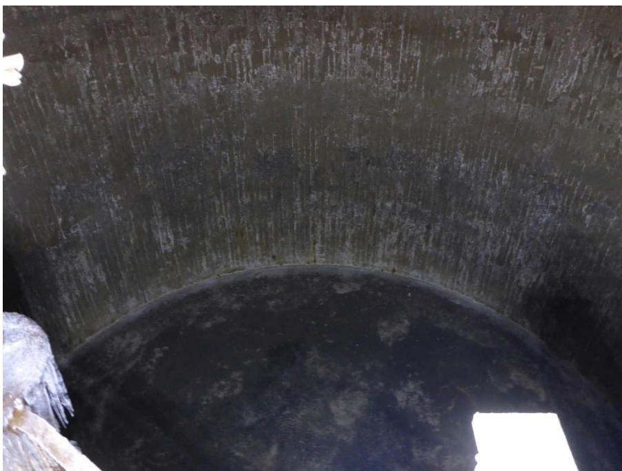
Kuva 16, säiliön seinän alareunassa paljastuneita teräksiä
