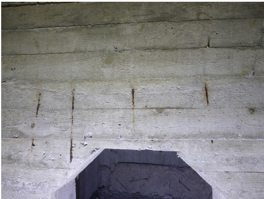
Kuva 11, välipohjan palkissa paljastuneita teräksiä
