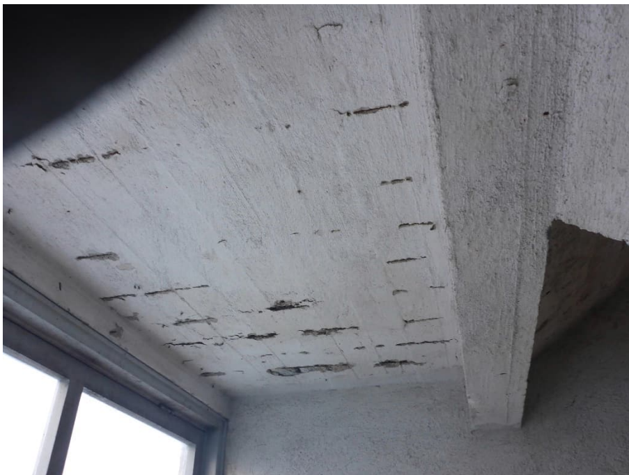
Kuva 7, paljastuneita teräksiä porraskäytävässä
