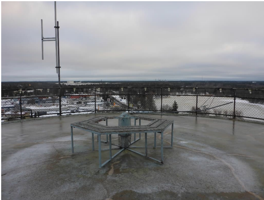
Kuva 18, vesikatolla säliön tuuletusputki, laatussa halkeamia
