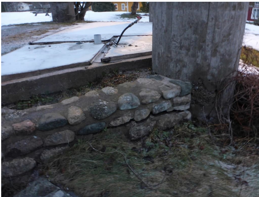
Kuva 5, tukimuri murtunut, taustalla kioskin peruslaatta
