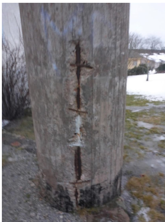
Kuva 2, merkittävin vaurio pilarissa
