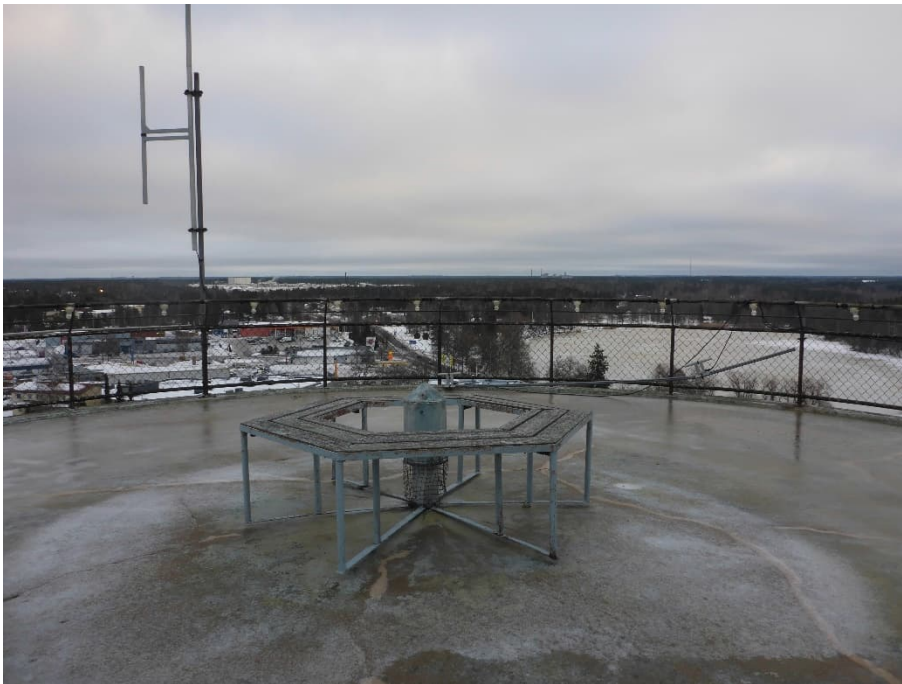
Kuva 18, vesikatolla säliön tuuletusputki, laatussa halkeamia
