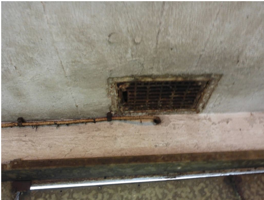
Kuva 20, porrastornin ilmanvaihtoritilä pahoin ruostunut
