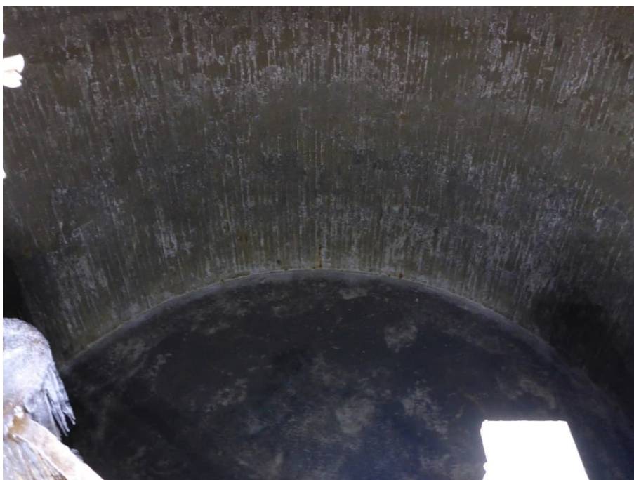
Kuva 16, säiliön seinän alareunassa paljastuneita teräksiä
