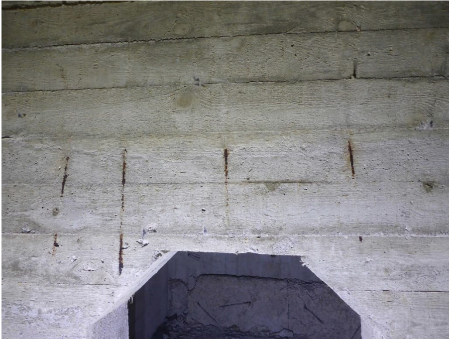
Kuva 11, välipohjan palkissa paljastuneita teräksiä
